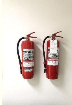
ถังดับเพลิง
